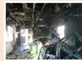
LiB発火が原因で 火災となった リサイクル工場設備
