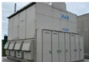
大型蓄電システム施設
