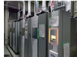
【高性能ボイラ】
